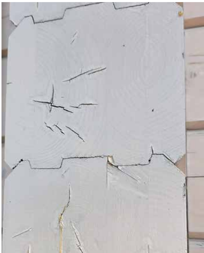
Фото торца с растрескиваниями и отслоениями лакокрасочного покрытия.
