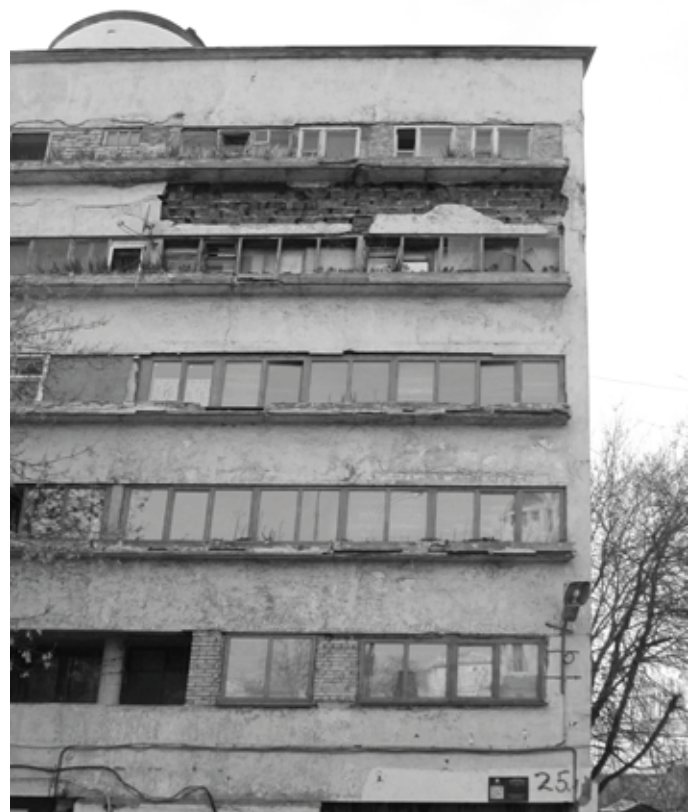
Восточный фасад до начала проведения реставрационных работ. Разрушение штукатурного слоя на фасаде в осях 4-28. 2016. ООО «ПФ-ГРАДО».
