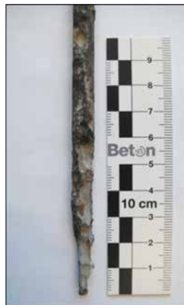
Фото 4. Коррозия арматуры под воздействием хлоридов.
