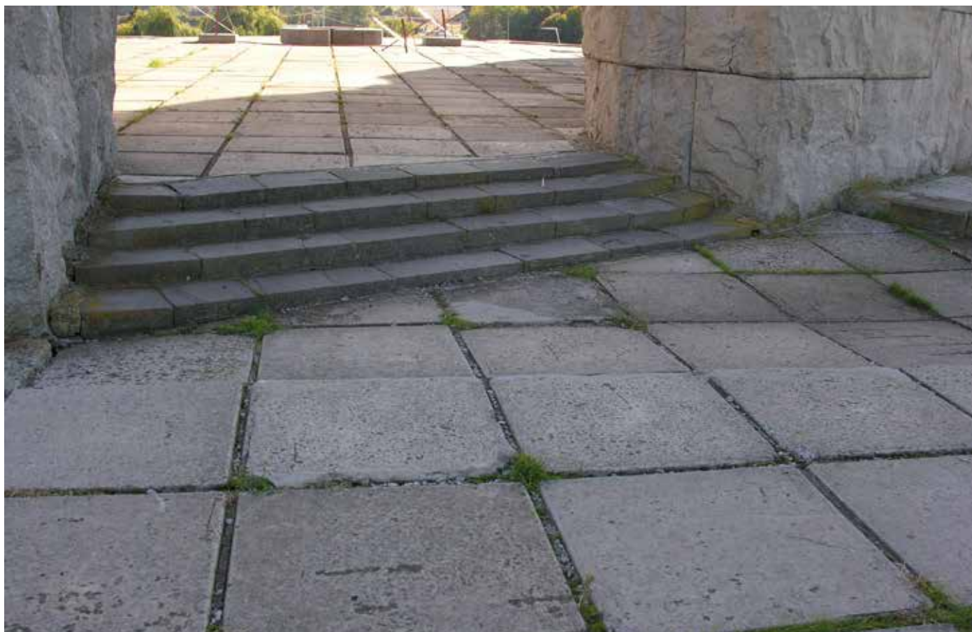
Фото 4. Состояние Мемориала до проведения работ.
