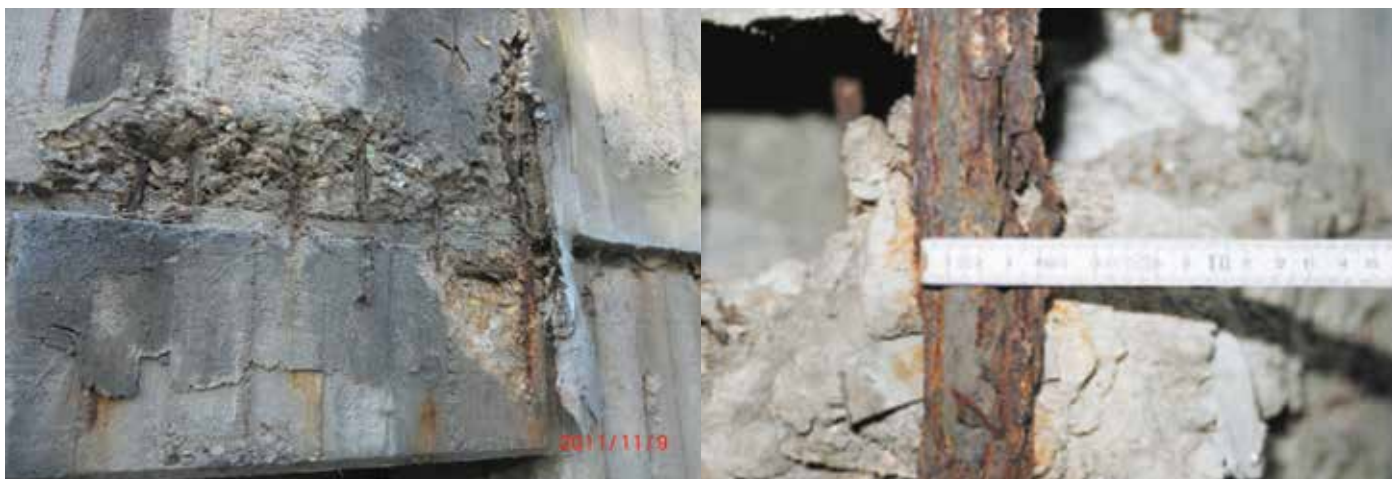
Фото 3. Коррозия железобетонной конструкции, включающая разрушения бетона и арматуры.
