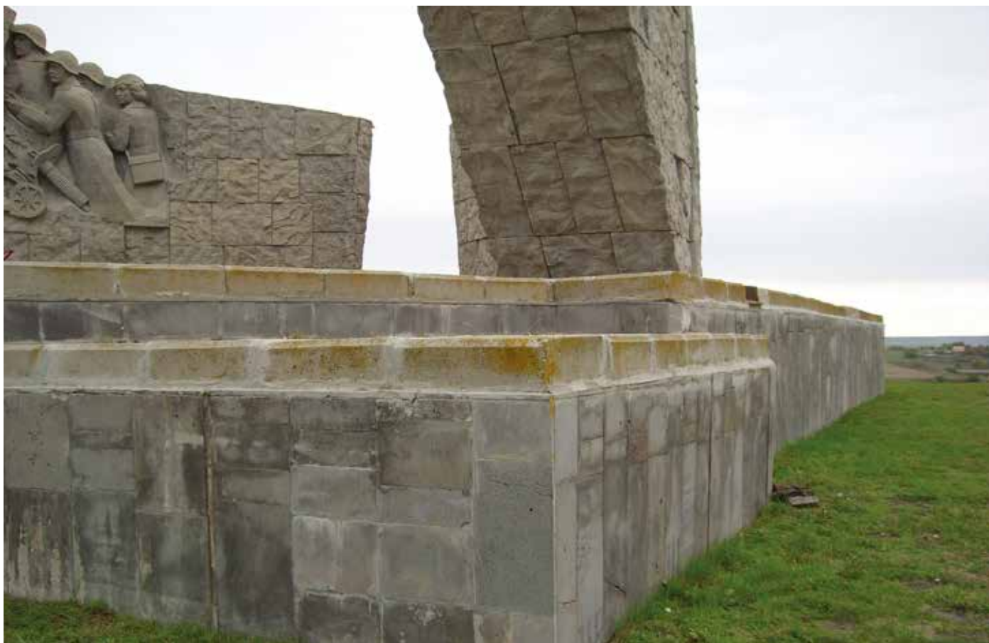
Фото 2. Состояние Мемориала до проведения работ.
