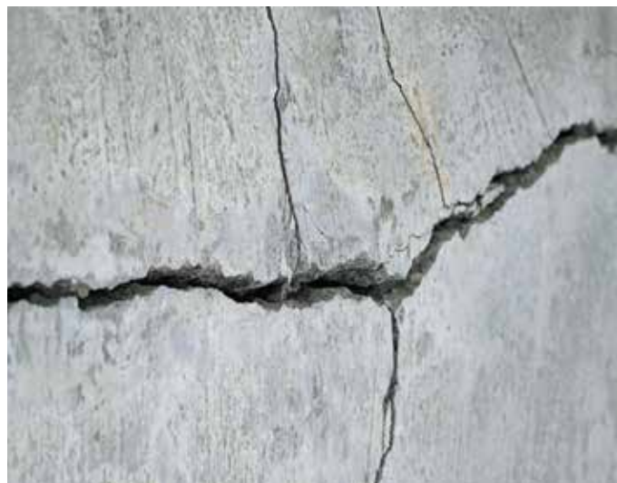
Фото 5. Трещины в железобетонной конструкции.
