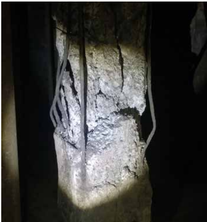
Фотофиксация аварийной колонны в подвале жилого корпуса, состояние на 2016 г. ООО «ПФ-Градо».
