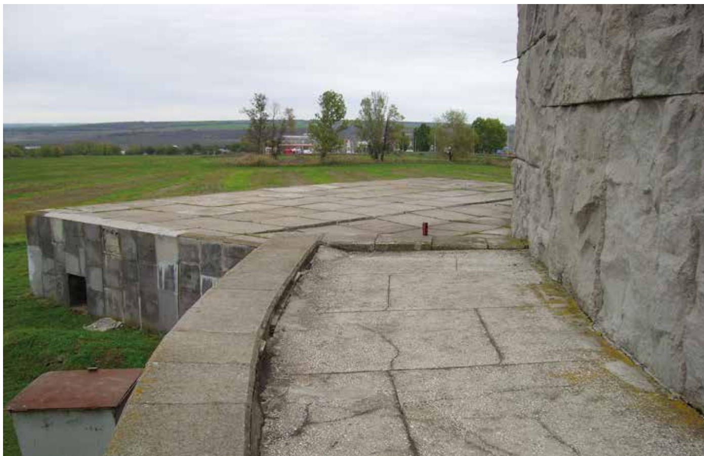
Фото 3. Состояние Мемориала до проведения работ.
