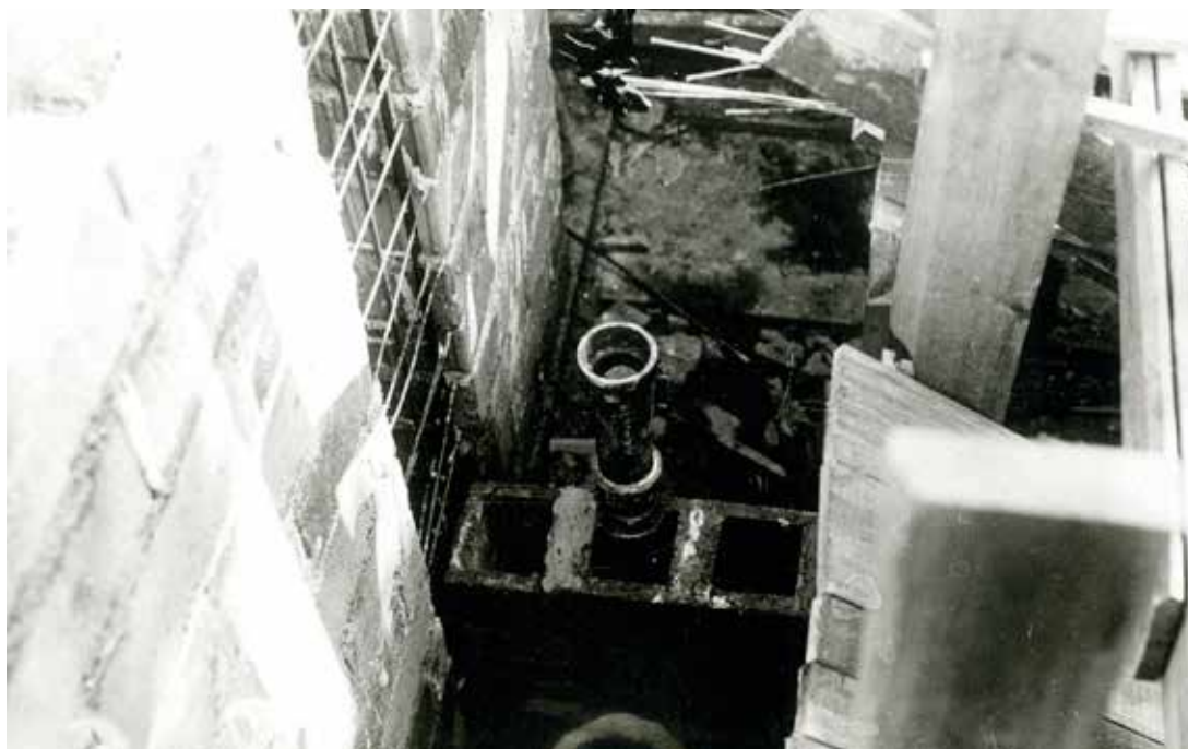
Вертикальные инженерные коммуникации, проходящие через полости квадратного сечения блока «Прохоров». 1930. Архив семьи Гинзбургов.
